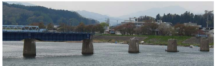
宮古市閉川の鉄橋、現在も被害のそのままの姿です。
